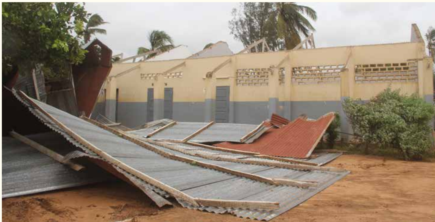
O esforço de reconstrução pós-Dineo continua, havendo ainda salas por reabilitar
